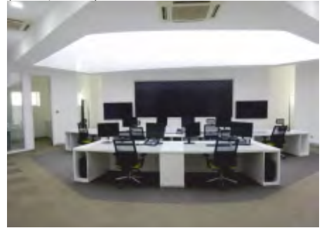
MINI SCADA CONTROL CENTER AND VOIP SYSTEM ERBIL-IRAQ
