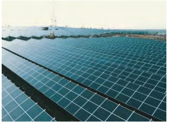
ÇORUM SOLAR POWER PLANT-TÜRKİYE
